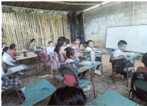
Foto 3. aula que le falta muro perimetral de block y sustitución de piso de torta de concreto y sustitución de estructura de soporte y sustitución de lámina.
