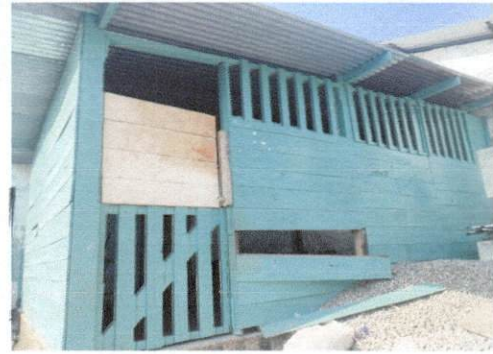
Foto 2. aula que le falta muro perimetral de block, porque el perímetro de madera ya se pudrió, el cual hay que hacerlo y sustitución estructura de soporte de madera por metal y sustitución de lámina
