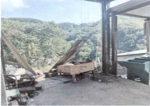
Foto 1. derrumbe del muro de contención de la cocina, se necesita reparar el muro de contención, reparación de muro perimetral de blok, sustitución de piso de torta de concreto, sustitución de estructura de soporte y
